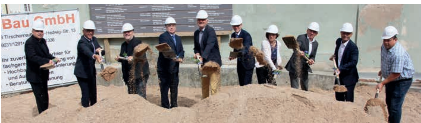
Erster Spatenstich an der Koloman-Maurer-Straße mit Stadtpfarrer Georg Flierl, Bürgermeister Franz Stahl, Architekt Peter Brückner, KWS-Generalbevollmächtigter Ludwig Gareis, Kämmerer August Trißl, die KWS-Mitarbeiter Maximilian Meiler, Brigitte Gries und Manfred Zeitler sowie Stellv. Landrat Dr. Alfred Scheidler und Bauunternehmer Hans-Jürgen Schulwitz (v.l.) (Foto © Stadt Tirschenreuth)
